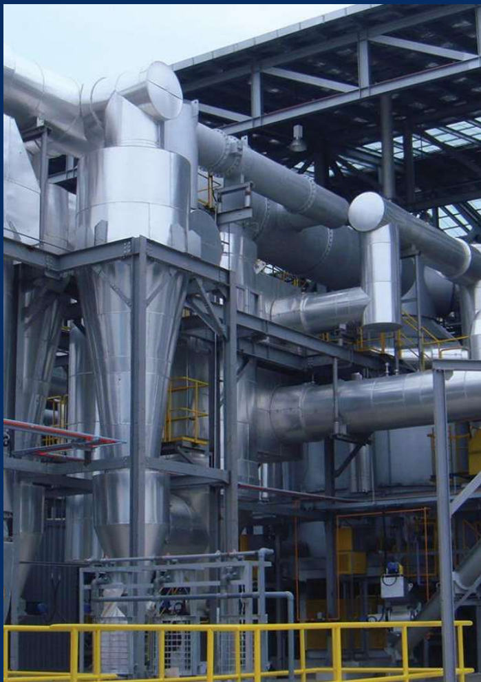
Traitement de déchets dangereux - Eco (Singapour)
