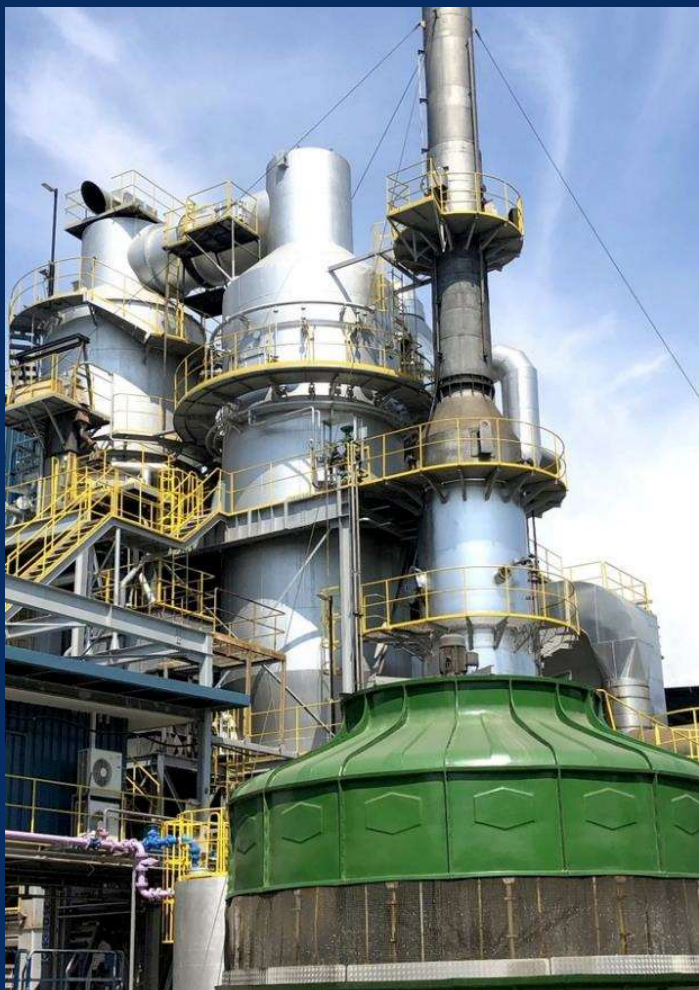
Traitement de déchets dangereux - Eco (Singapour)
