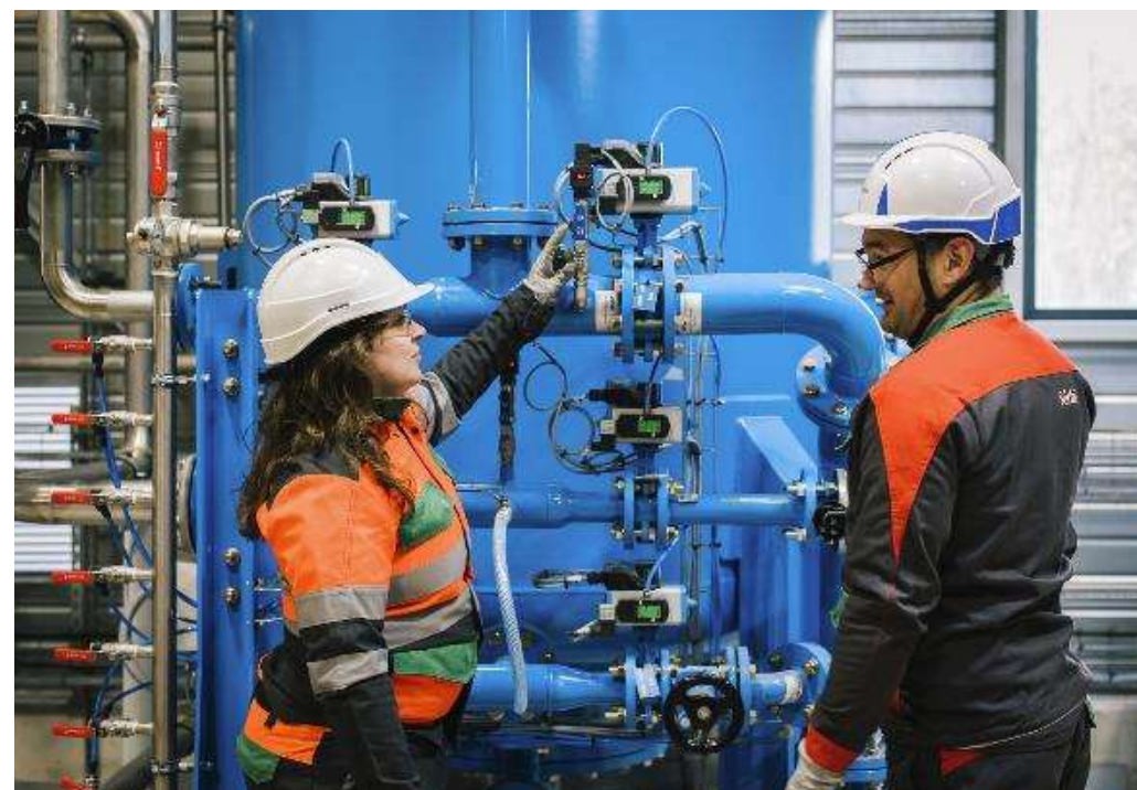
Sécché Traitement Eaux Industrielles (STEI)
