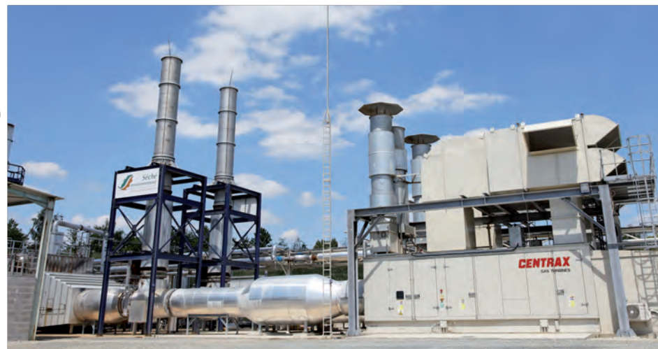
Turbine à gaz
