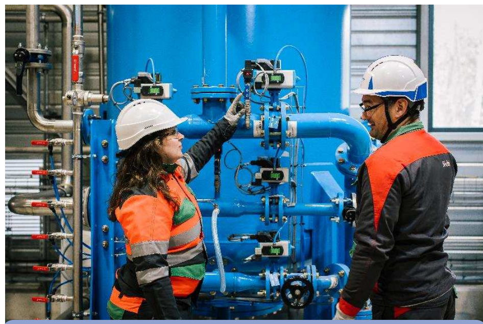
Séché Traitement Effluents Industriels -STEI- (France)
