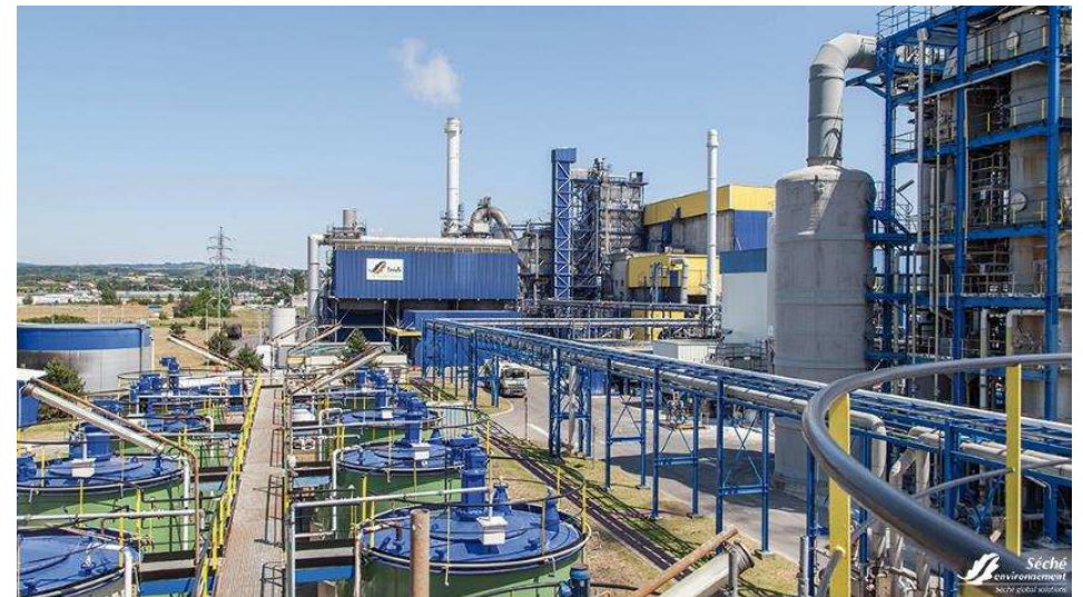
Site de Salaise-sur-Sanne (incinération de Déchets Dangereux avec valorisation énergétique)
